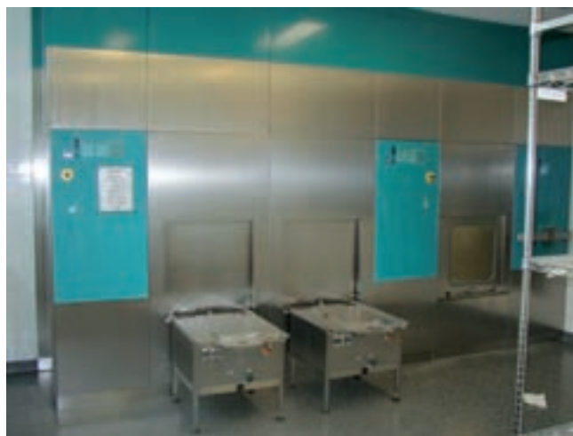
Alte Steris Packraum (vor dem Umbau)
